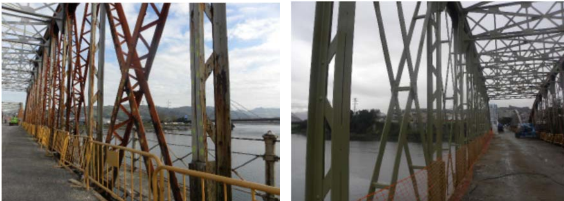
Figura 6. Diagonales. Antes y después de la intervención.
